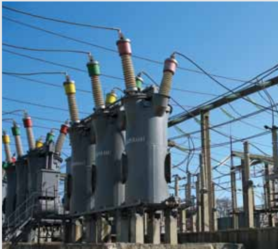
«Тольятинский трансформатор», г. Тольятти
